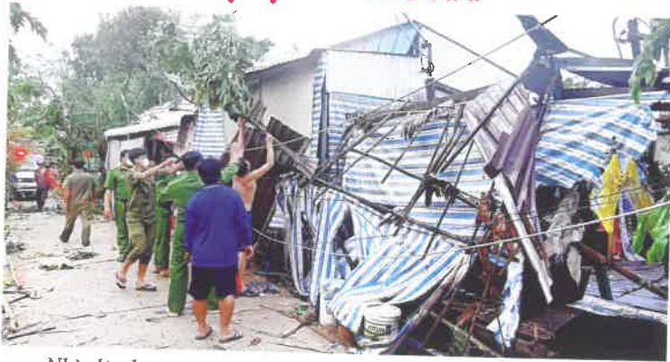
Nhà dân bị sập sau trận mưa lớn kèm theo giông, lốc ngày 27-3.
